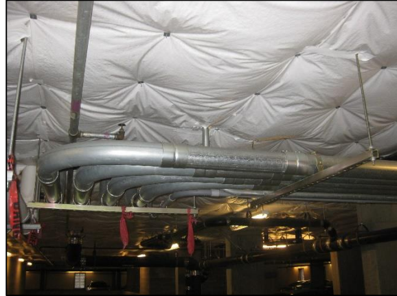
Photo A-12: Level 3—suspended conduits
